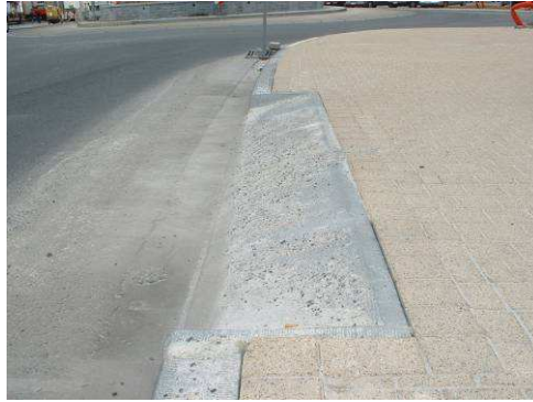
Illustration 3 : Traversée sans dalle pour les personnes déficientes visuelles et mal adaptée pour les personnes en chaise
