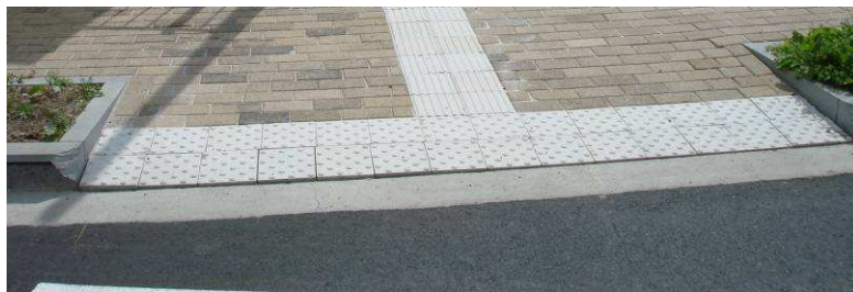
Illustration 4 : Dalles podotactiles mal positionnées par rapport au bord de la chaussée
