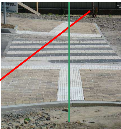
Illustration 5 : Dalles podotactiles mal orientées
