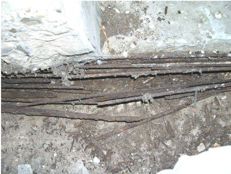
Gebroken en geroeste naspandraden van ligger K
