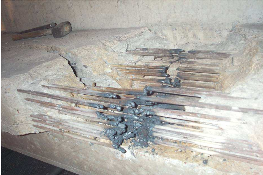
Doorgebrande naspandraden en opengespleten omhulling (links)
