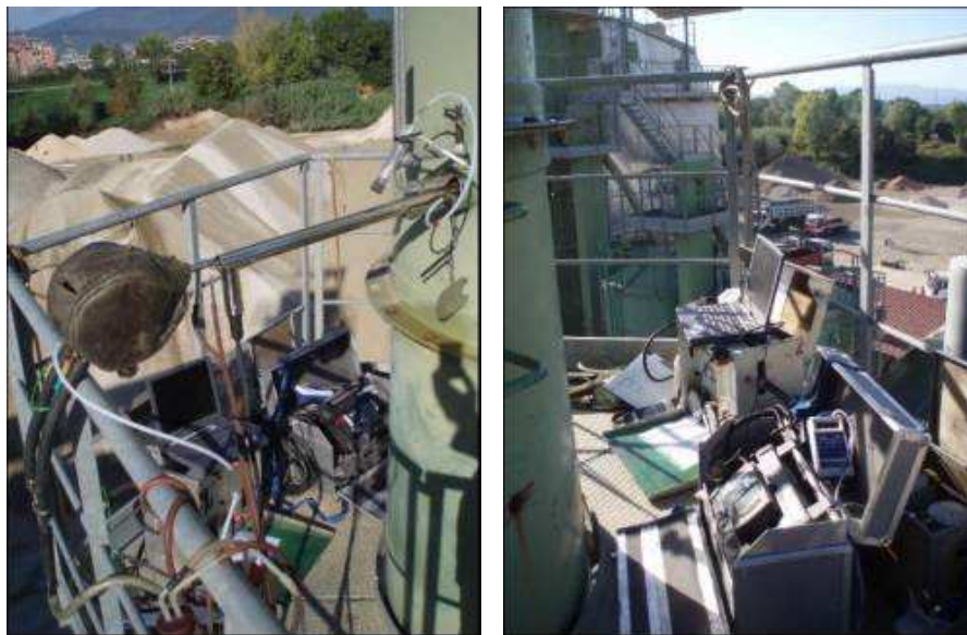
Figures 3 et 4 : Installations pour l'étude des émissions dans la centrale d'enrobage
