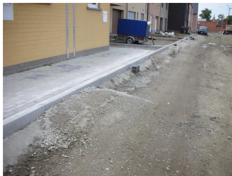
Figuur 2: Tijdelijke verhogingen ter hoogte van de boordsteen om de toegang tot de huizen mogelijk te maken.
