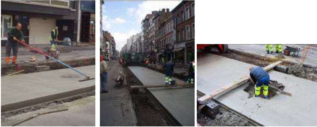
Figuur 7, 8 en 9 : Achter de machine wordt het betonoppervlak afgestreaken en gebeuren de laatste manuele afwerkingen ter hoogte van eventuele inspectieputten.
