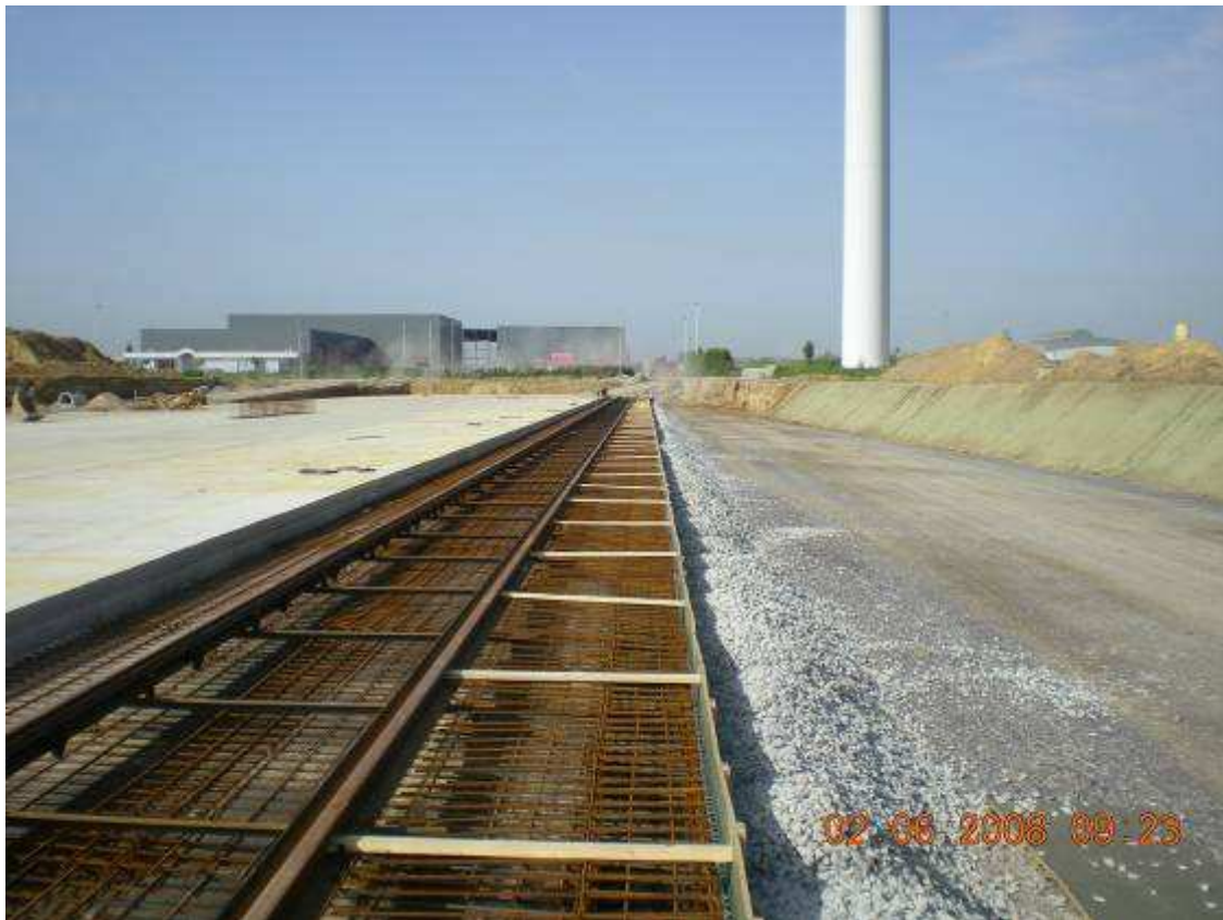
FOTO SPOREN IN BETON
