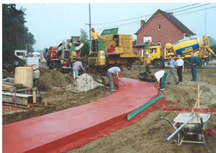
Illustration 5 : mise en œuvre d'un béton coloré rouge pour une piste cyclable à Aarschot
