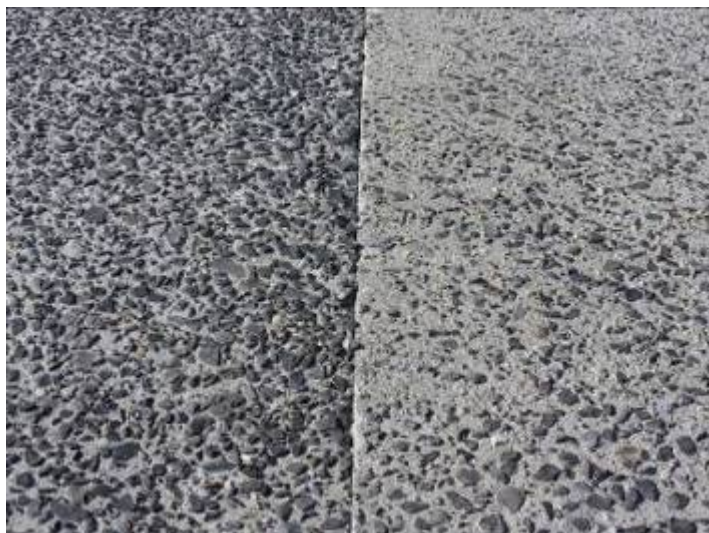
Illustration 9 : aspect d'un béton discontinu après dénudage, à gauche sans vibration du béton ; à droite, avec vibration (texture insuffisante)
