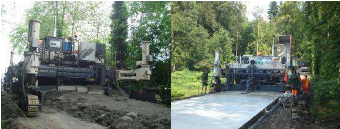
Illustration 6 : mise en place du béton à l'aide d'une machine à coffrages glissants (chantier Eurovia – TSBV – Condroz-Beton à Crupet, 2011)
