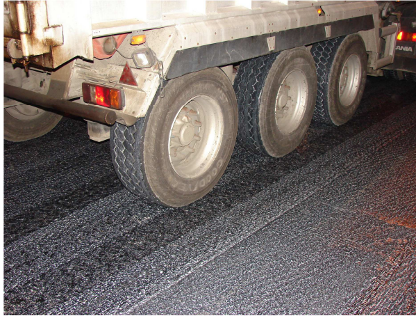
Figure 7 : Application du lait de chaux stabilisé dilué sur la couche de collage lors du chantier de la nationale N25. L'absence de traces de bitume sur les pneumatiques du camion est criante.
