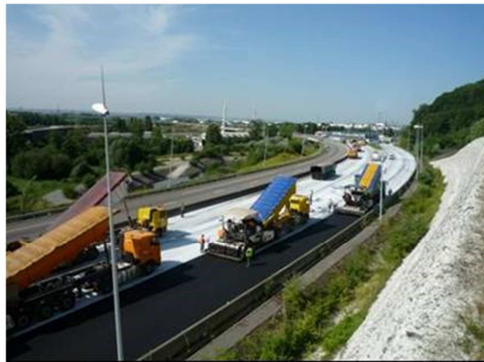
Figure 1 : Mise en œuvre d'enrobés sur l'autoroute A29 en France avec couche de collage traitée au lait de chaux.
